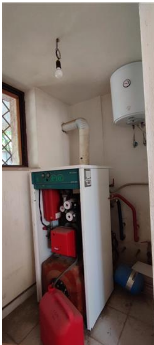
zona della centrale termica a piano seminterrato con caldaia a gasolio e scaldino elettrico
